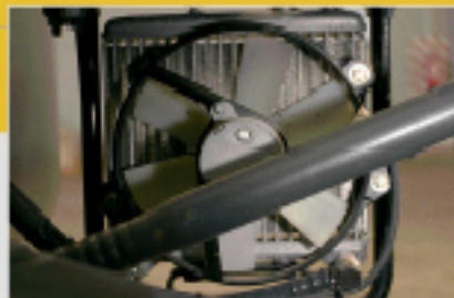
Enfriador caja de transferencia.
